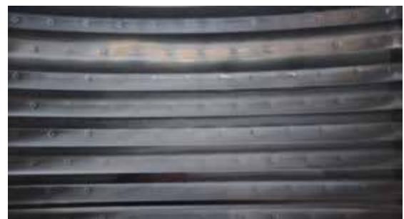
Interno lucido di intercapedine "Termostar", nella zona della trapuntatura, viene rilucidata la lamiera
